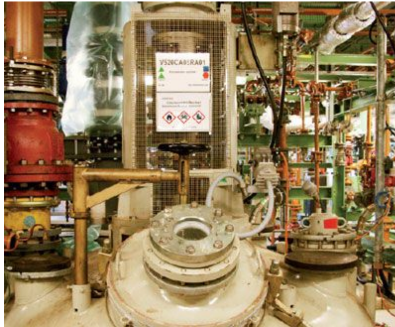
Abbildung 14: Innerbetriebliche Kennzeichnung von Anlagen
